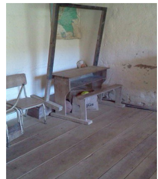
Resumidero, los salones aún se encuentran en piso de tabla dificultando su funcionalidad y aseo
