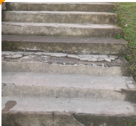
Por su largo tiempo de construcción y uso estas áreas comunes presentan un alto deterioro
