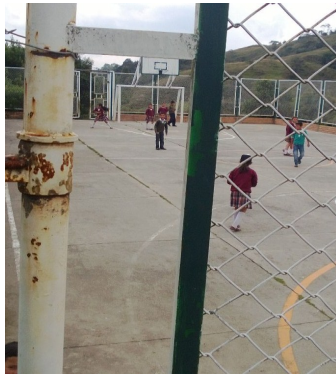
Polideportivo la Amistad, requiere de mantenimiento para evitar su deterioro
