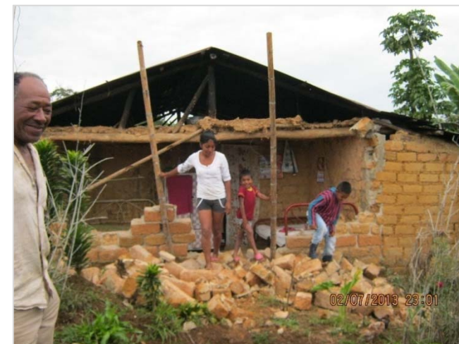
Colapso del muro de una vivienda en Cajibío (Cauca).
